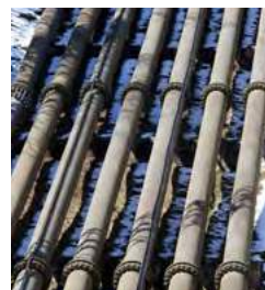
Conduites forcées à Eget
